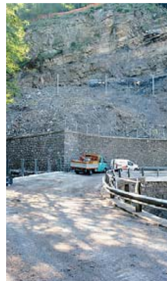
La strada dove è caduta la frana
